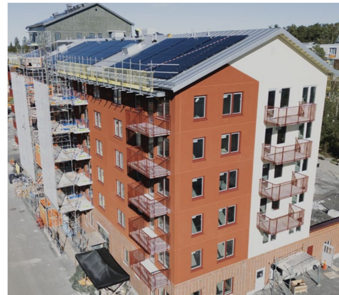
Nyproduktionsprojektet Hasselnöten med solpaneler monterade på tak.
